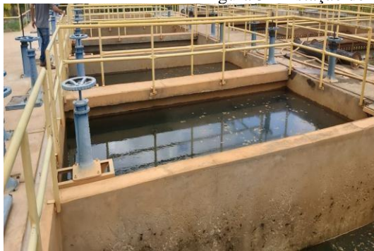
(a) Tanque de Coagulação/Floculação
