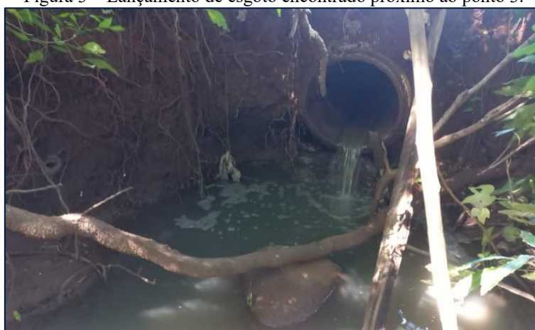
Figura 3 – Lançamento de esgoto encontrado próximo ao ponto 3.
