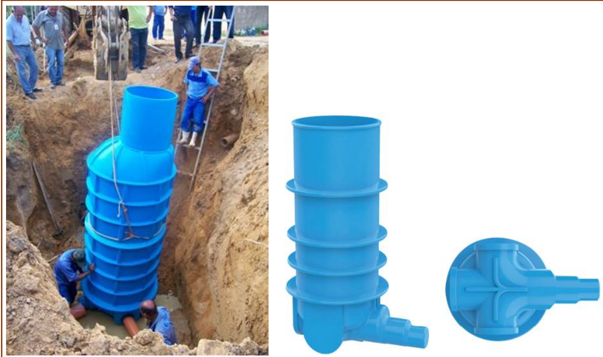
Figura 10 – Poço de inspeção em material plástico (esq.), e vista de um poço de inspeção (dir.).
