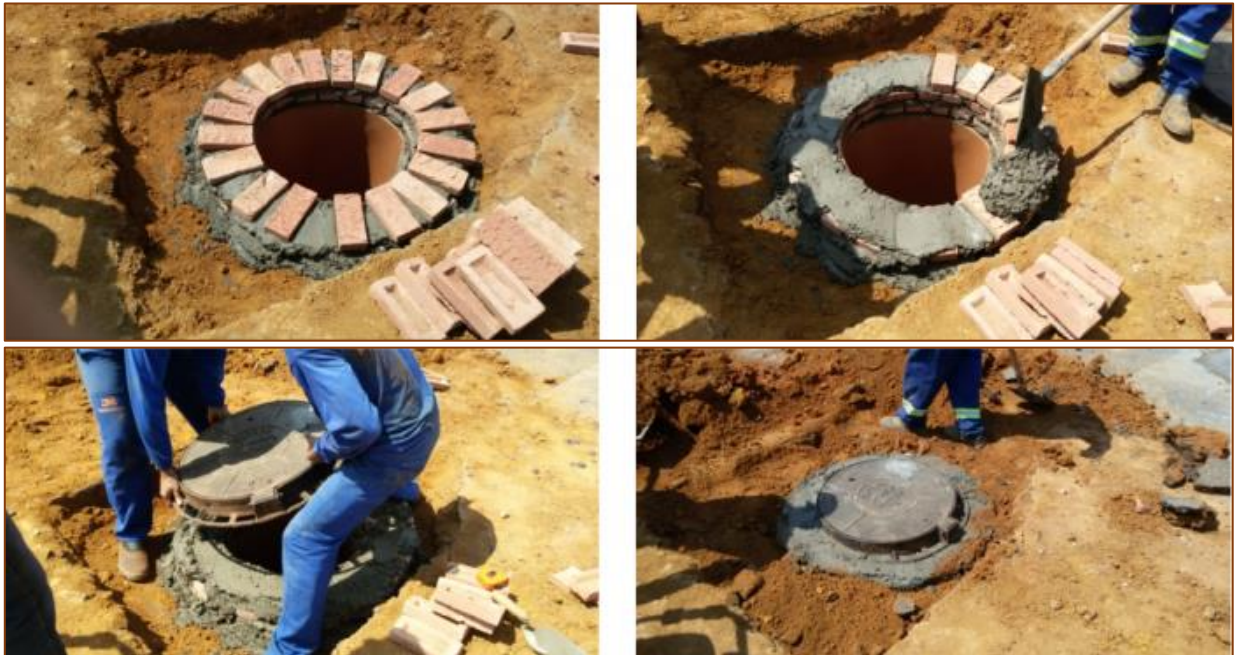
Figura 03 – Finalização de instalação de Poço de Visita, com nivelamento ao nível do passeio e colocação da tampa metálica chumbada na alvenaria.
