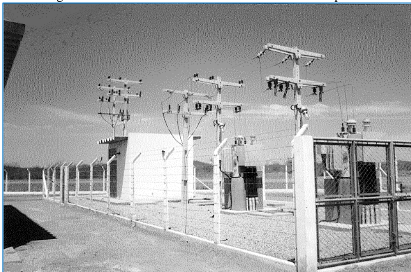
Figura 4.7 - Vista Geral de SE de média tensão ao tempo AIS
