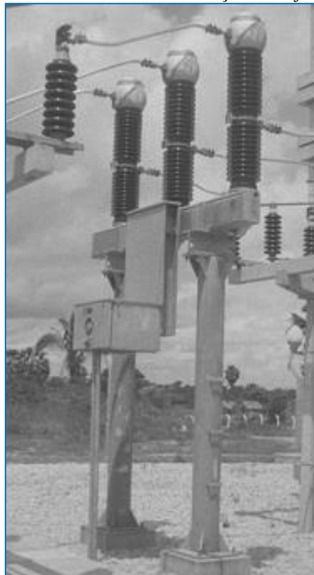
Figura 4.18 - Vista com detalhe da instalação de disjuntor de 69 kV
