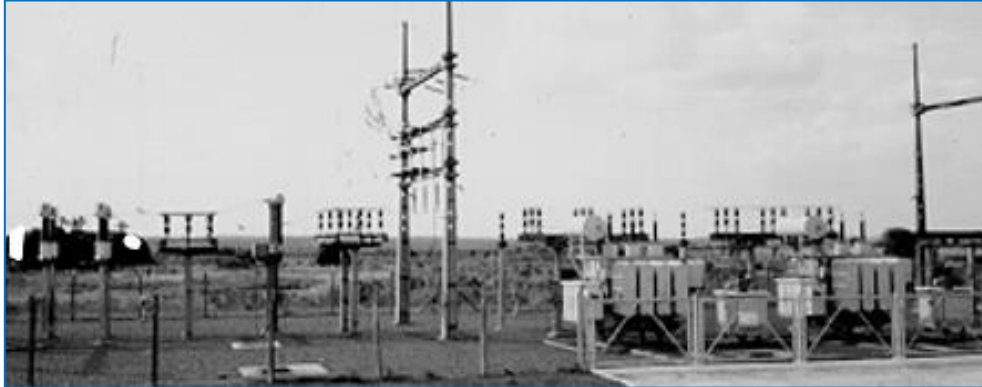
Figura 4.17 - Visão geral da SE de 69 kV
