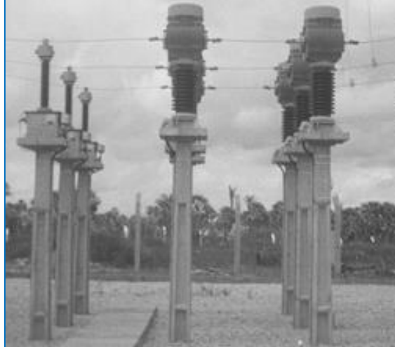
Figura 4.19 - Vista com detalhe da instalação de transformadores para instrumentos em uma SE de 69 kV
