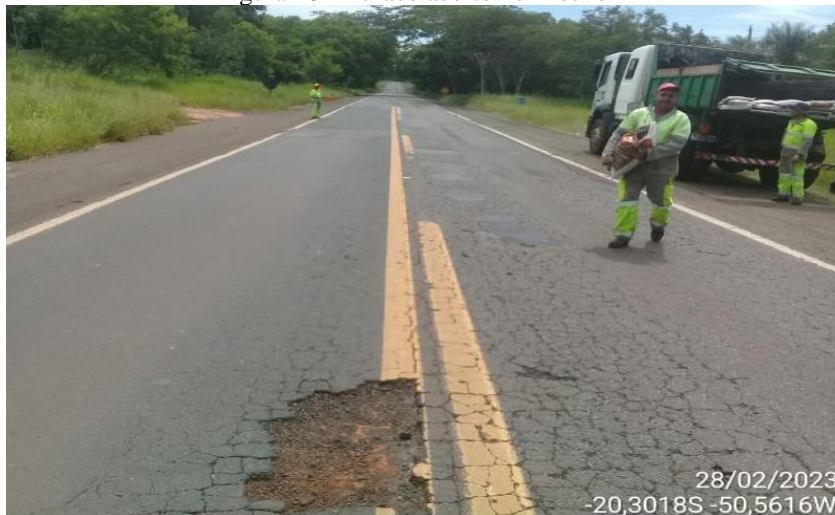
Figura 18 - Buraco aberto no Trecho 4
