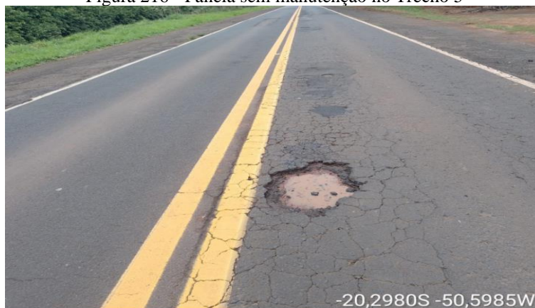
Figura 216 - Panela sem manutenção no Trecho 5
