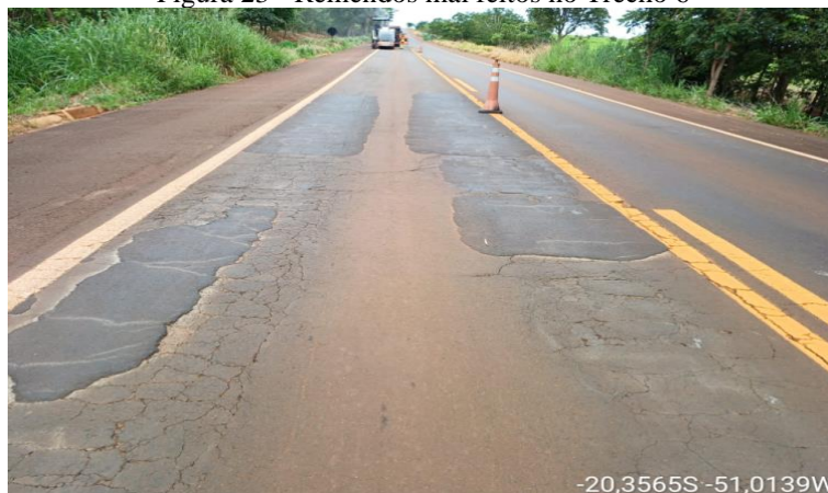
Figura 23 - Remendos mal feitos no Trecho 6
