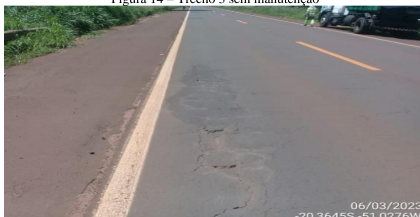
Figura 14 – Trecho 3 sem manutenção
