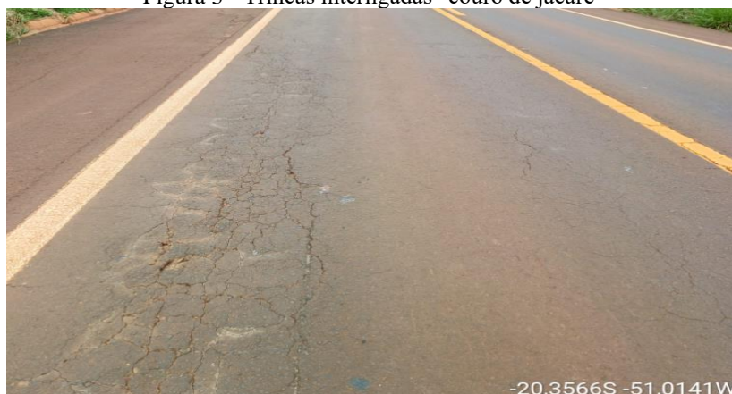
Figura 3 - Trincas interligadas “couro de jacaré”
