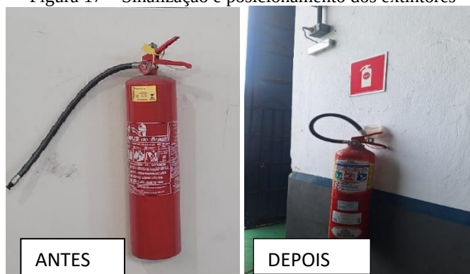
Figura 17 – Sinalização e posicionamento dos extintores
