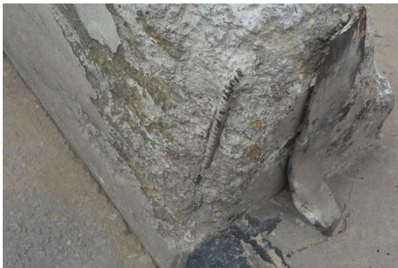
(d) Delaminated New Jersey Barrier (OAE 3)
